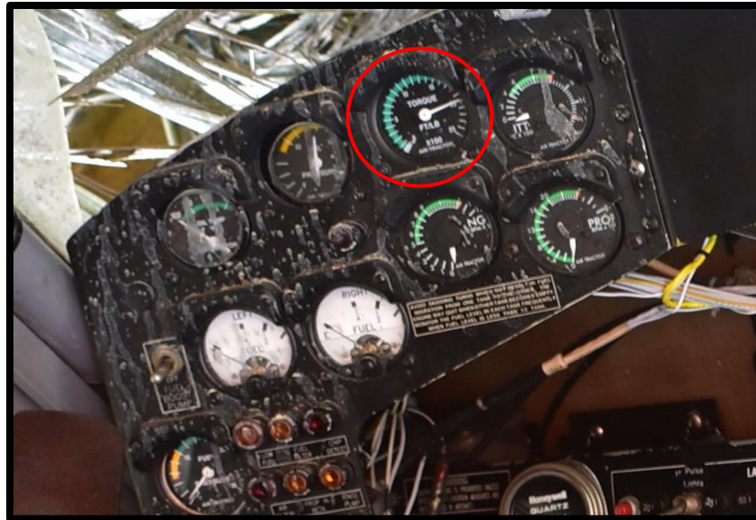
Fotografía No. 9 Vista del instrumento con daño por impacto del indicador de torque.
